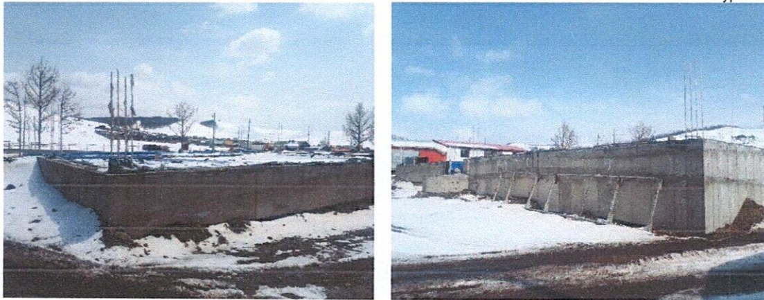
Барилгын хана өрөөгүй байхад өрснөөр акт үйлдсэн байдал
